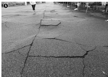
④1階部分が座屈した住宅⑤波打つ路面
