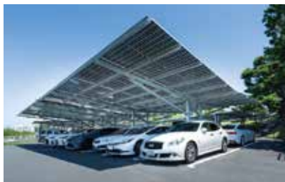
両面式太陽光パネルを用いることで 地面からの反射光でも発電可能
